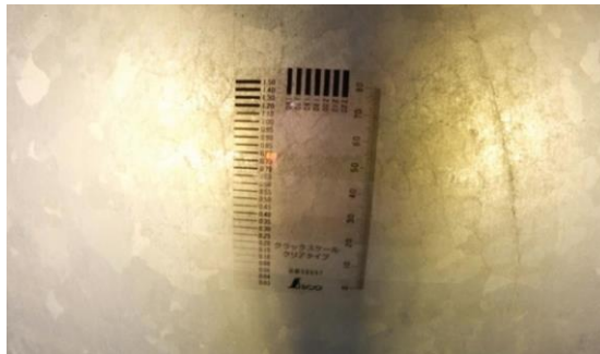
<図 2-10: 無人航空機により撮影された煙突内部のクラックスケール>
