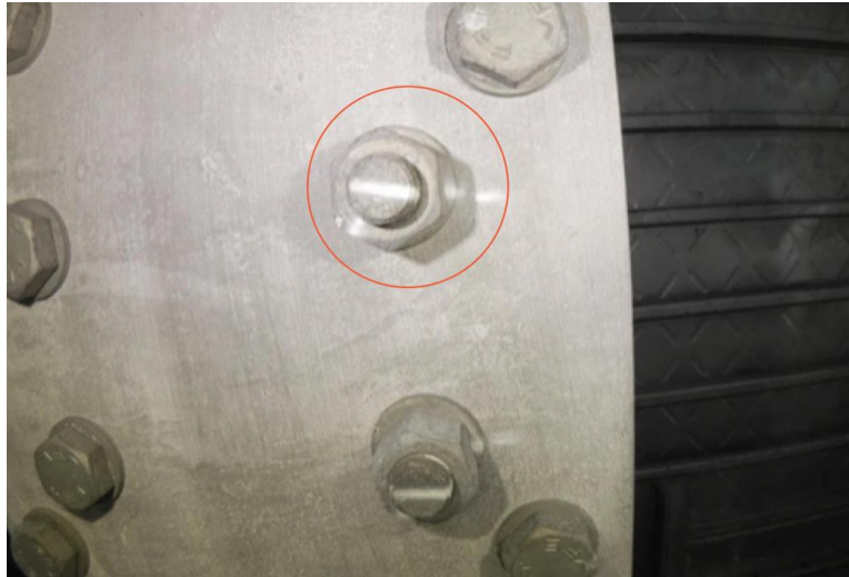
<図 2-7: 無人航空機により撮影されたボルトの緩み>
