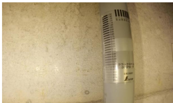
<図 2-15: 無人航空機により撮影されたトンネル内のクラックスケール>
