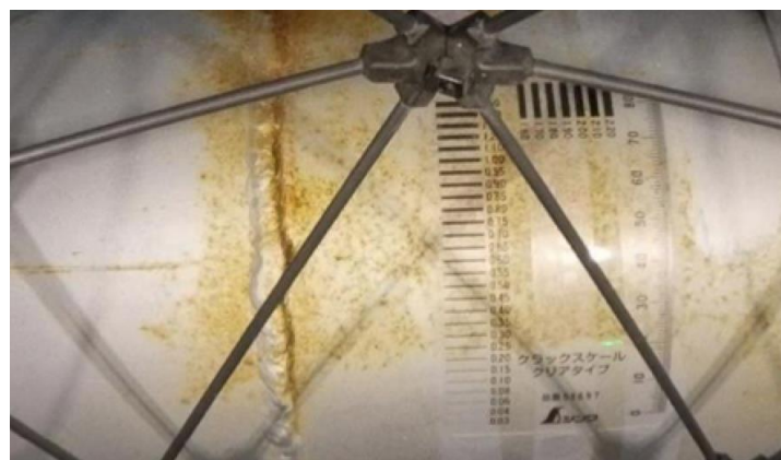
<図 2-9: 無人航空機により撮影されたパイプとクラックスケール>
