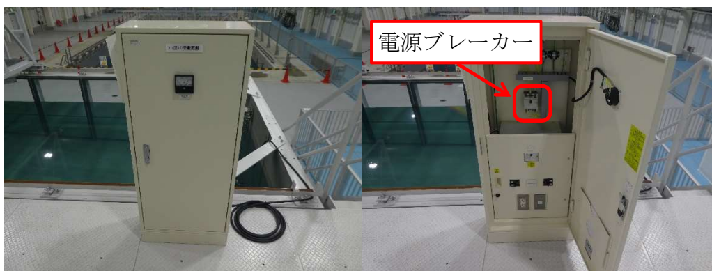
小型水槽電源盤（外観）
