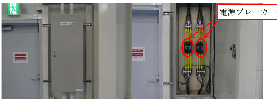
水中ミキサー端子盤（外観）
