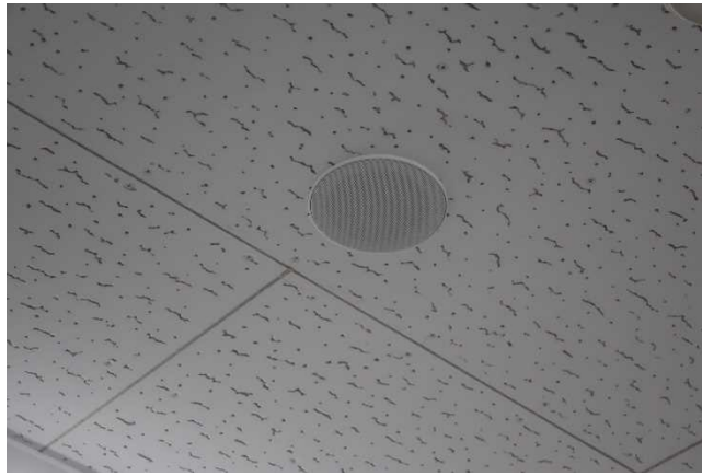
インカム設備（操作室内スピーカー）
