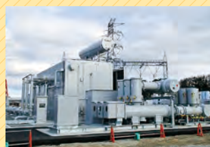
都路変電所(田村市)
